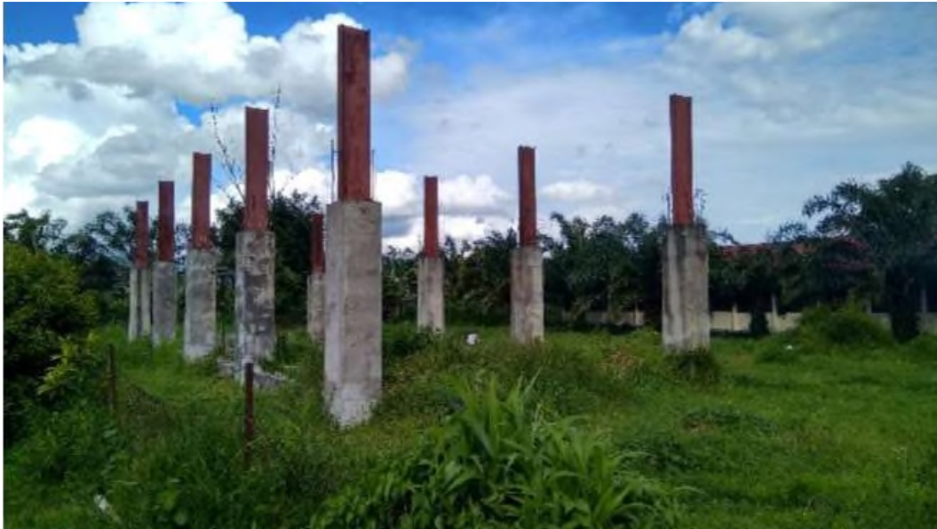
Gambar 6 : Pembangunan gedung pabrik mini pengolahan kelapa sawit yang terbengkalai sejak tahun 2014.
