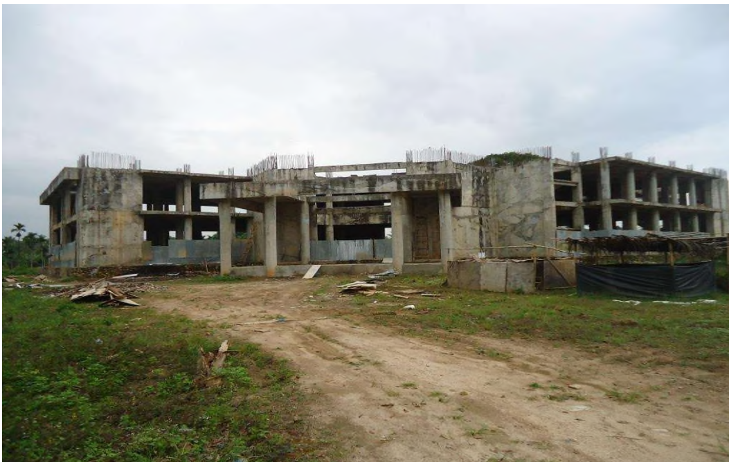
Gambar 5 : Pembangunan gedung kuliah bersama D3 dan D4 yang terbengkalai sejak tahun 2015
